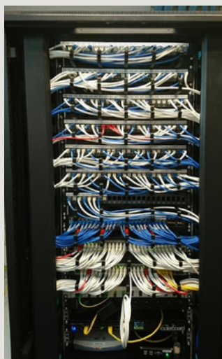
Exemple de brassage dans une baie de brassage
